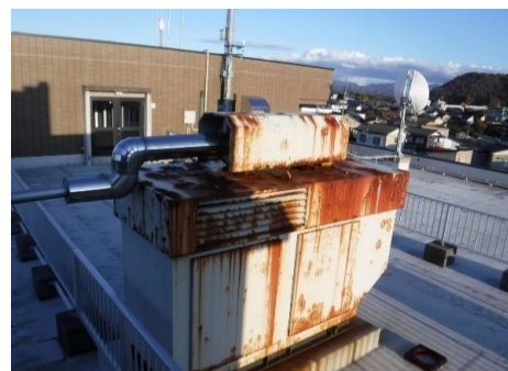
更新する発動発電設備
