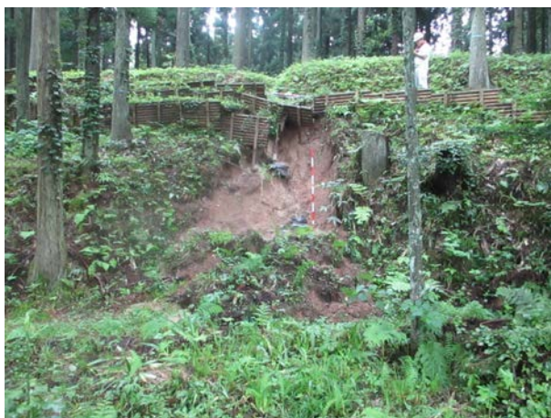
写真7 管理用道路法面崩落状況（H29）
