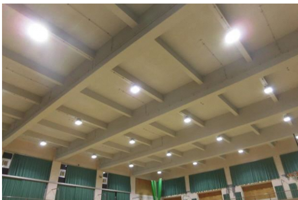
屋内運動場の LED 照明
