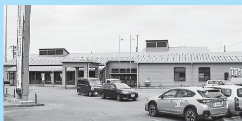
外壁の割れが見られる山北支所庁舎
