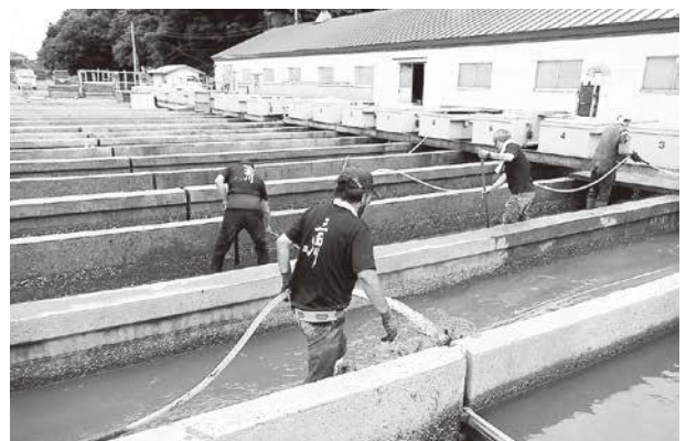
浸水被害を受けた第三ふ化場（三面川鮭産漁業協同組合）
