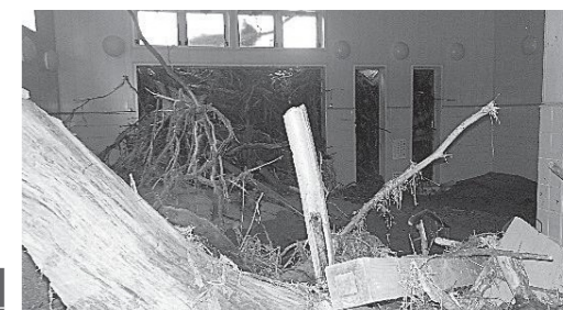
▲施設内は土砂と流木に覆われました
