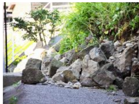
▲市道岩崎2号線石積み崩落状況
