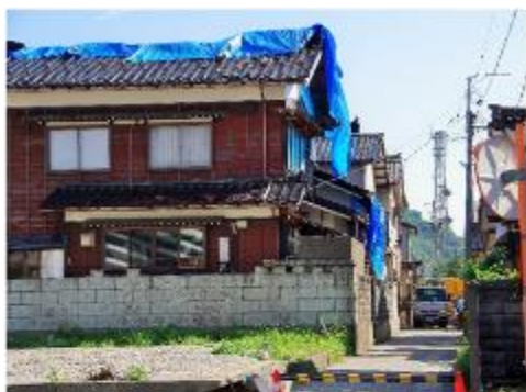
▲府屋地内（駅前通り）建物被害状況
