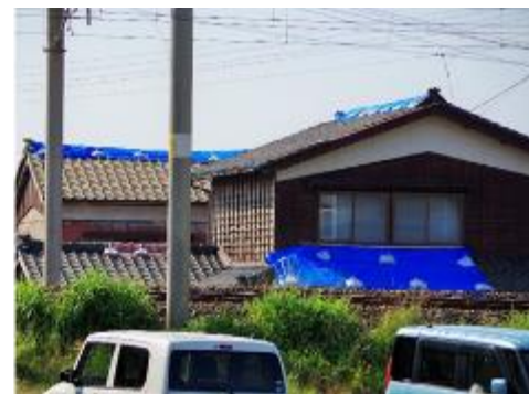
▲府屋地内（浜町）建物被害状況
