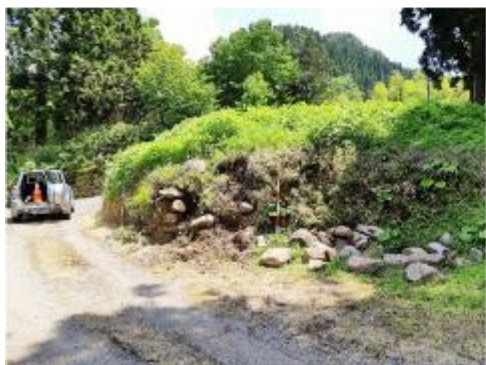
▲市道板屋沢 2 号線沿線の石積崩落
