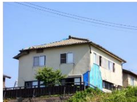
▲府屋地内（駅前通り）建物被害状況
