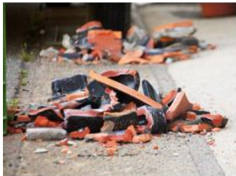
▲府屋地内（落下した瓦）
