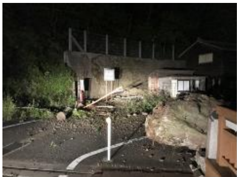
▲市道基石出戸線の落石
