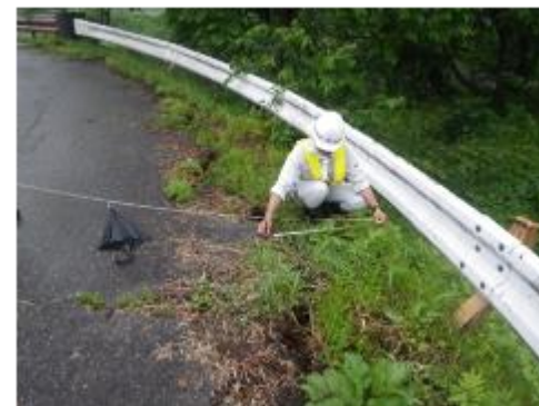
▲市道小俣 18 号線の路肩沈下
