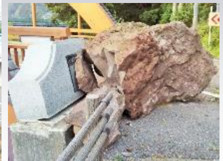
(2019.6.18 山形県沖地震被害の様子)
