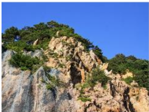
▲国道 345 号弘法トンネル付近の山腹斜面
