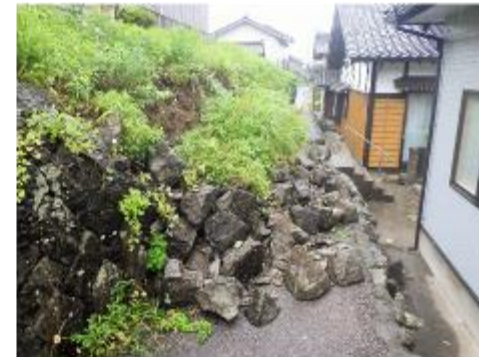
▲市道岩崎2号線沿線の石積崩
