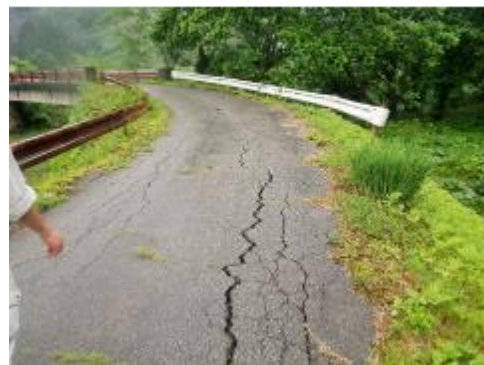
- 9 - ▲市道小俣 18 号線の舗装クラック
