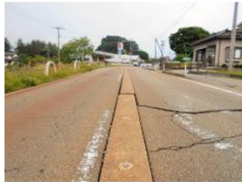
▲市道府屋 1 号線の舗装クラック 及び消雪パイプ破断
