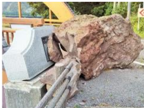
▲市道基石出戸線の落石
