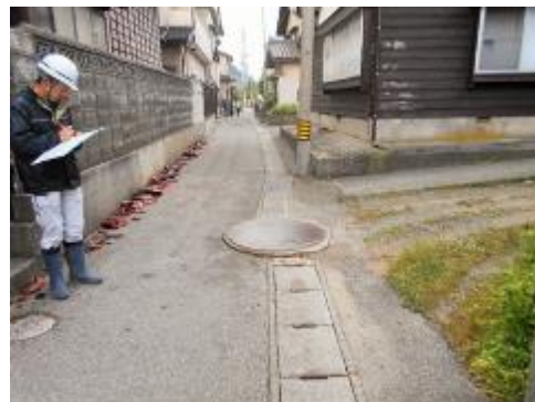
▲市道府屋 10 号線のマンホール隆起
