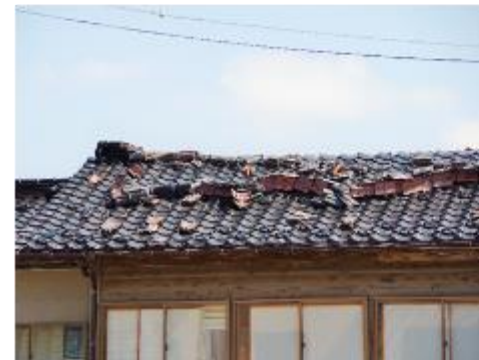
▲府屋地内建物被害状況
