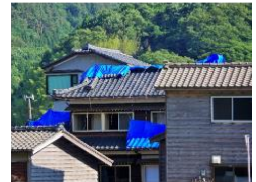
▲府屋地内建物被害状況
