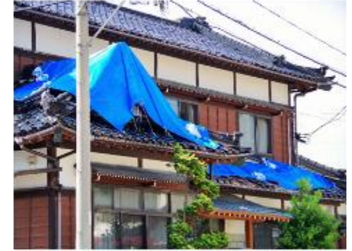
▲府屋地内建物被害状況
