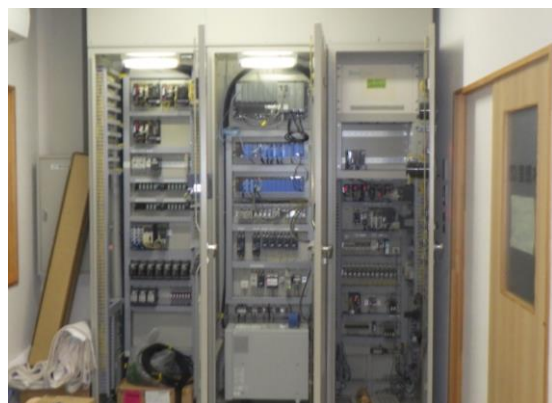
老朽化している山北地区遠方監視設備
