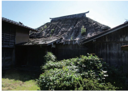
荒廃した武家住宅
