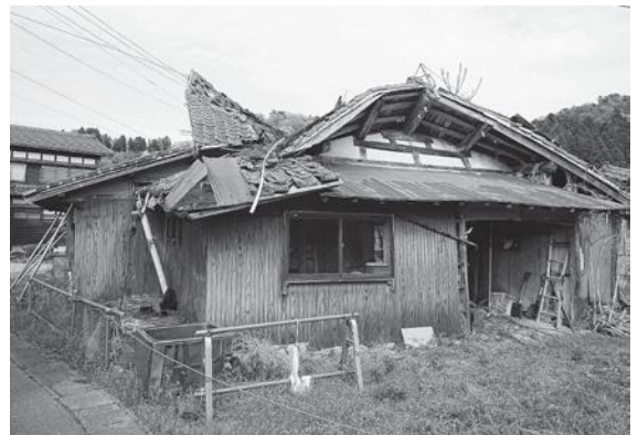
景観だけでなく、周辺の通行や衛生面に悪影響をもたらす危険な空き家
