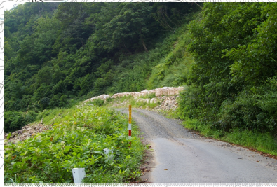
法面崩落箇所
