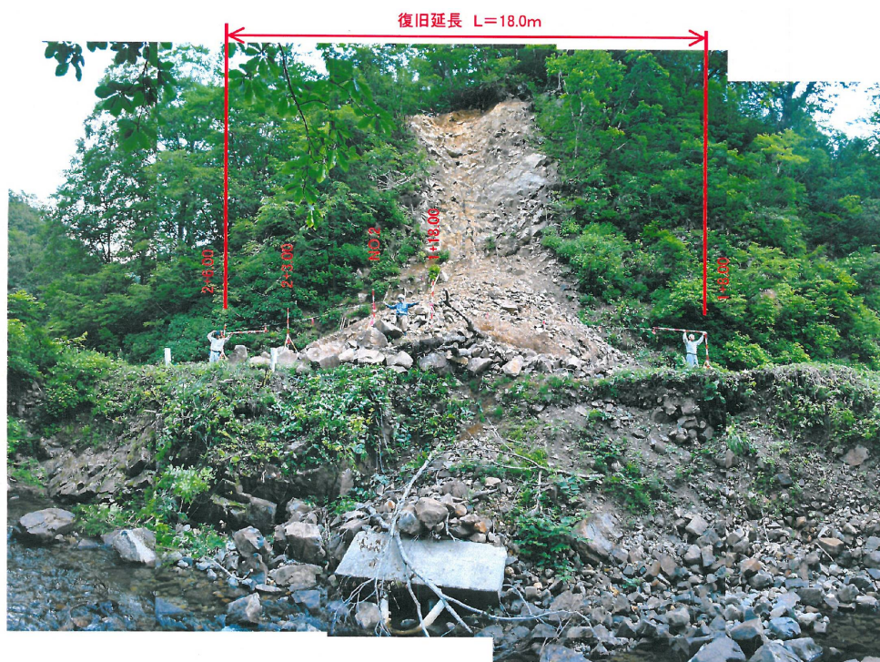
22 災 5704 号(斜面崩壊)
