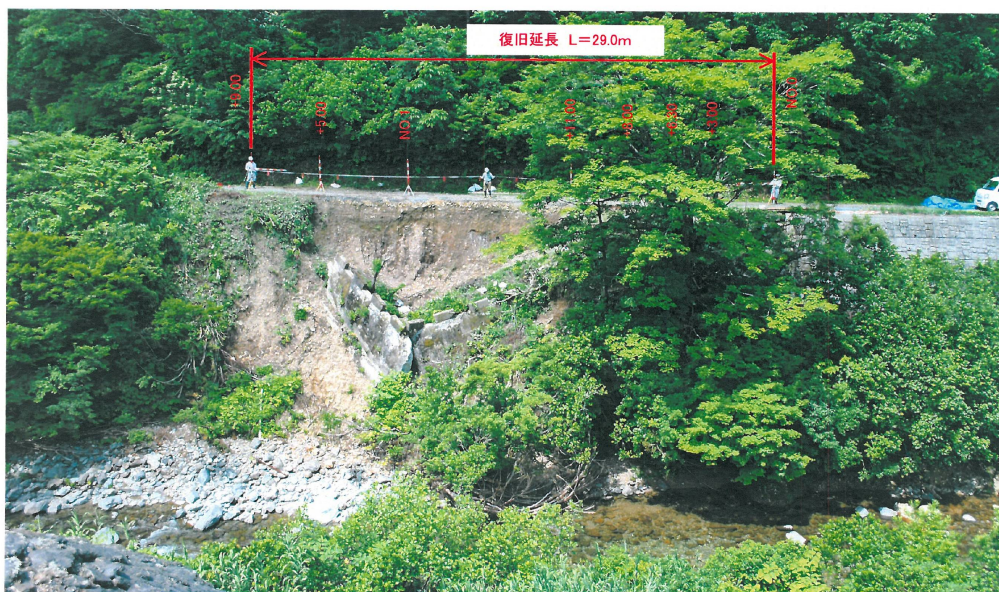
23 災 5701 号(路体崩落)
