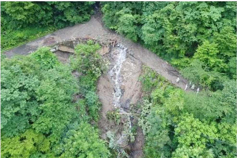
令和元年7月の被災状況（村上市）
