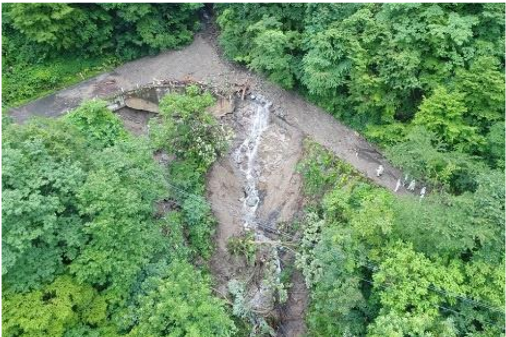
令和元年7月の被災状況（村上市）
