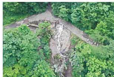
令和元年7月の被災状況（村上市）
