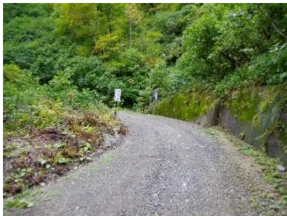
シミズ沢付近未舗装部（鶴岡市）
