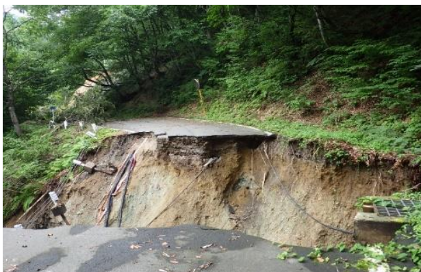
被災状況(12.9kp)
