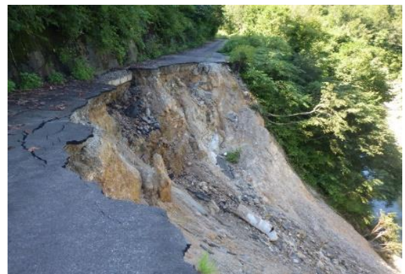
被災状況(20.5kp)
