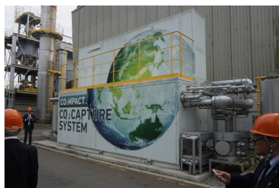
CO 2 回収装置
