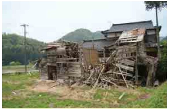
荒廃した建物
