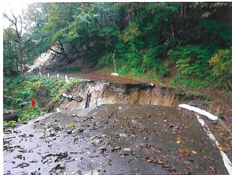
令和4年8月の大雨による被災状況 (村上市)
