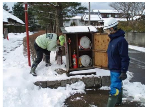
図 文化財に設置された消防設備
