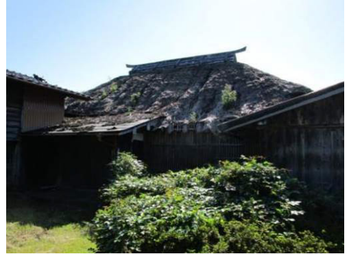
図 荒廃した武家住宅
