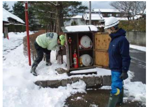
図 文化財に設置された消防設備
