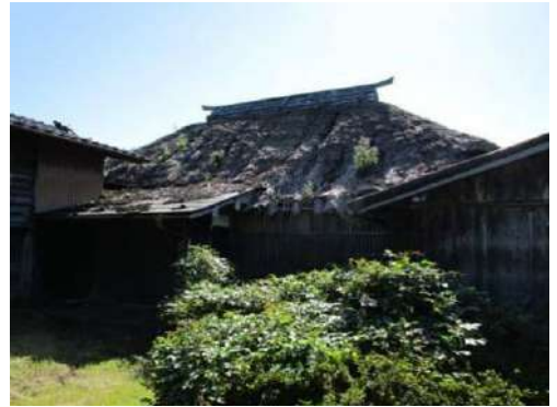
図 荒廃した武家住宅
