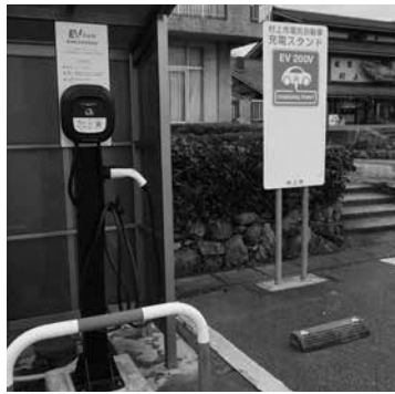
イヨボヤ会館に設置された充電スタンド
