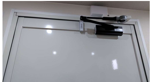
【荷物掛けフック(出入口扉)】
