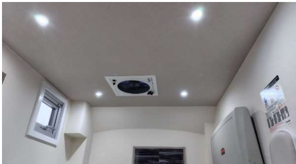
【換気扇・室内照明】
