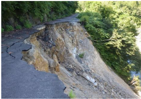
被災状況(20.5kp)
