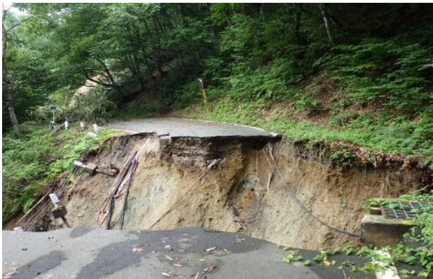
被災状況(12.9kp)
