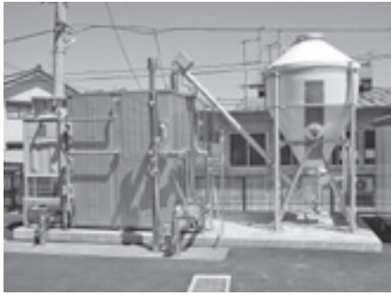
木質ペレット焚空調システム
