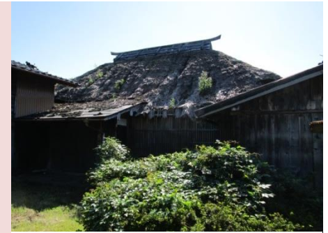
荒廃した武家住宅
