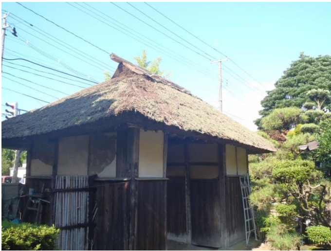
経年による痛みが見られる建造物
