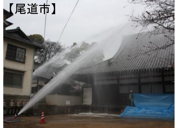
防災のために設置した防災設備
