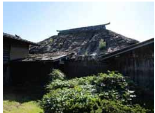
図 荒廃した武家住宅
