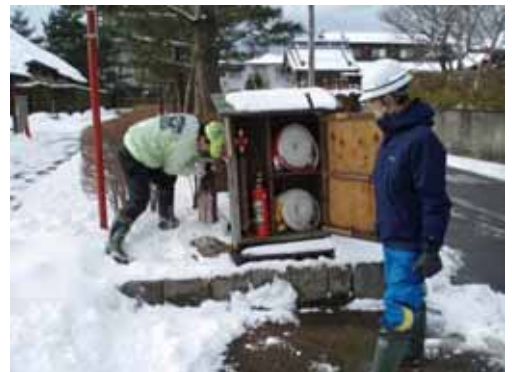
図 文化財に設置された消防設備
