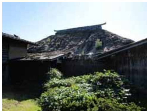
図 荒廃した武家住宅
