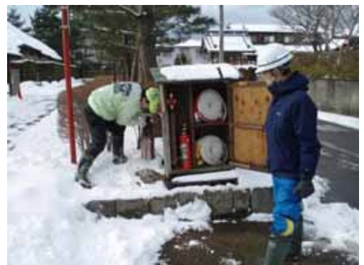
図 文化財に設置された消防設備
