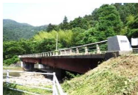
老朽化が進む大鳥橋
