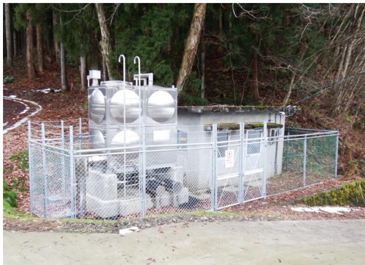
上山田地区飲料水供給施設
