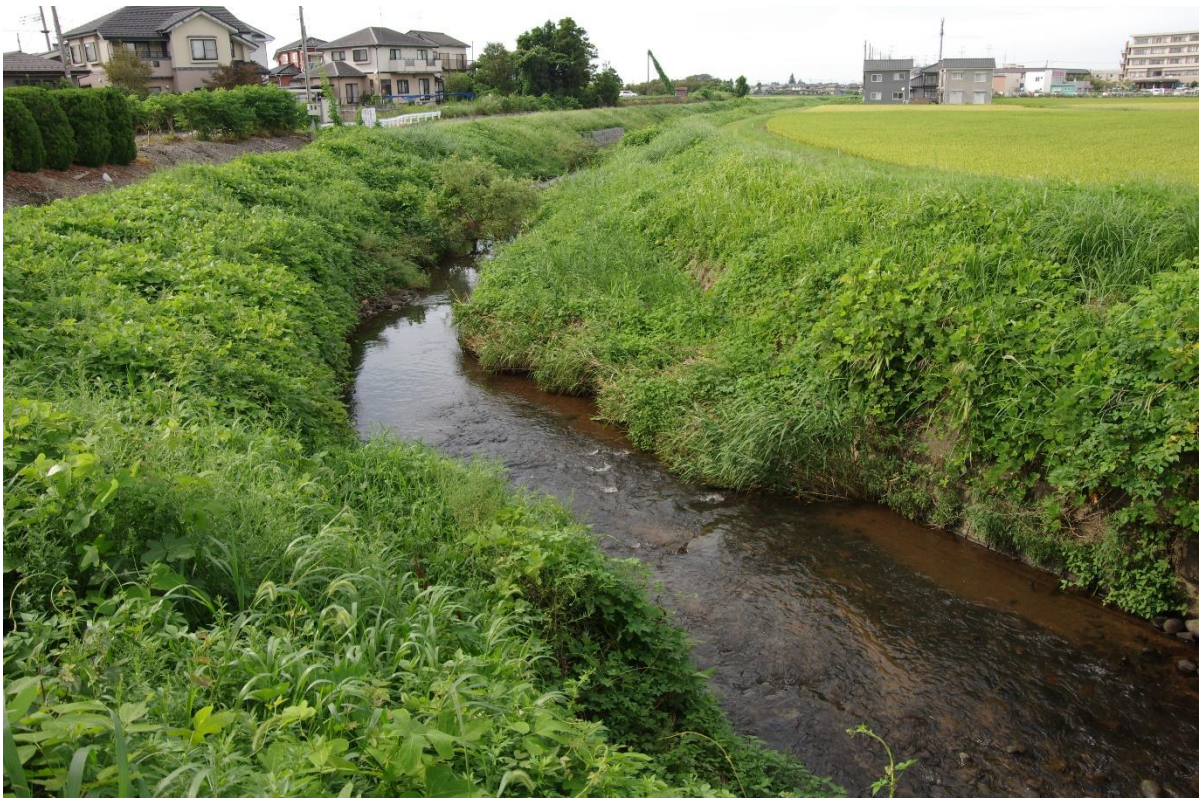
土砂が堆積し川幅を狭めている鳥川の状況（国道7号下流）
