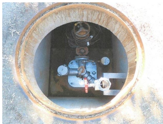
消雪パイプ用井戸に設置された金具
