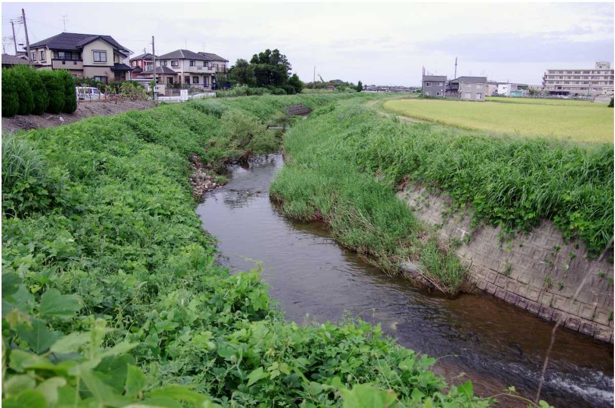
土砂が堆積し川幅を狭めている鳥川の状況（国道7号下流）
