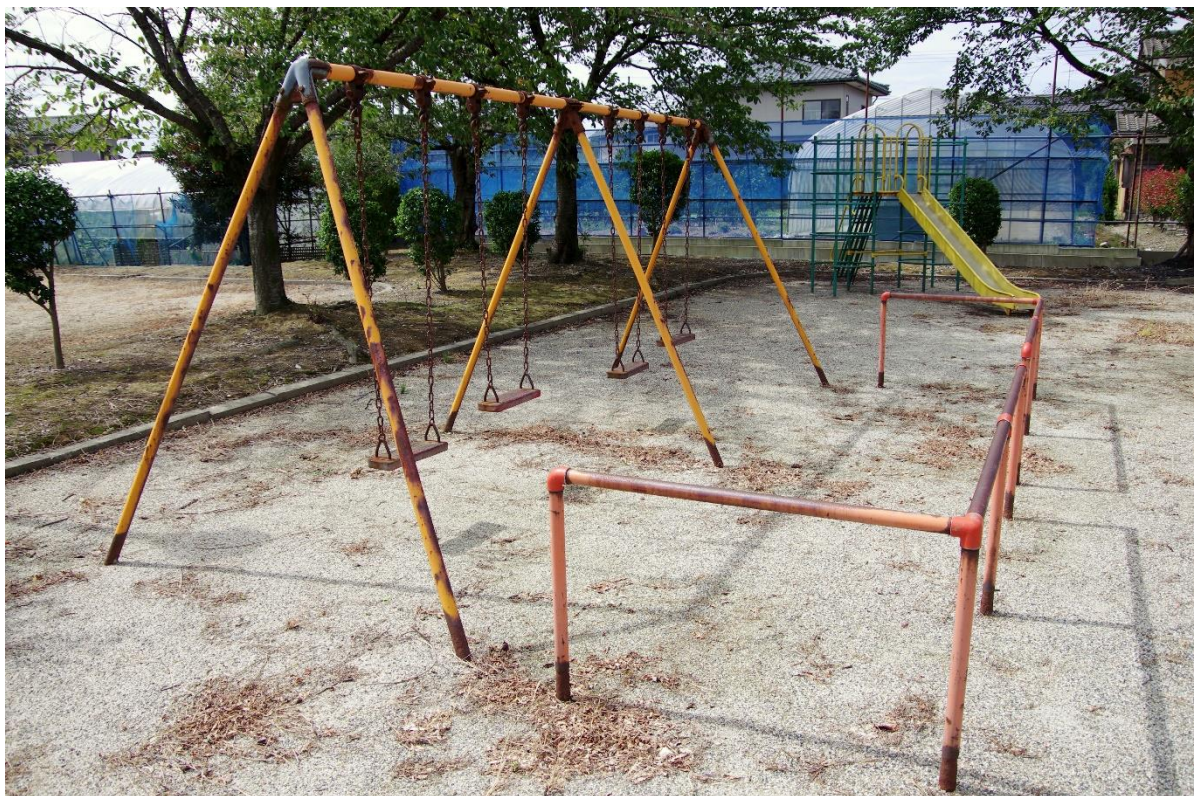
老朽化が進んでいる遊具（海老江農村公園）
