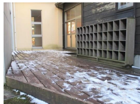
補修予定のウッドデッキ
