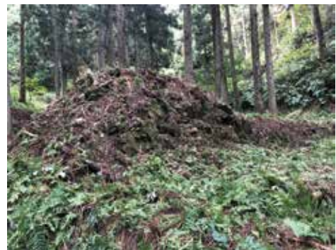
崩壊した田口中門跡石垣
