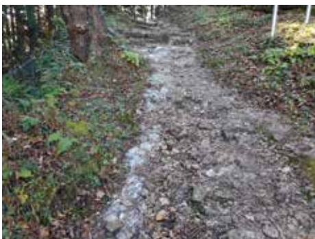
雨水による登城道の洗掘（本丸下）
