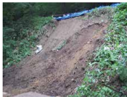
七曲り登城道下法面の崩落
