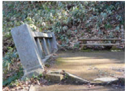
七曲り道のコンクリート製手摺りの傾斜
