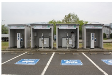
道の駅「関川」 急速充電 2 台、普通充電 2 台
