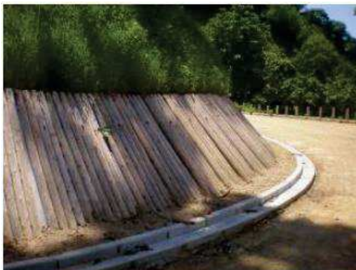
基幹林道 大毎北中線「木材を利用した林道補強の例」（新潟県 HP より引用）
