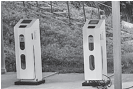
市内に設置されている充電器 (写真は瀬波温泉「はぎのや」)
