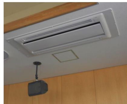
空調設備の更新
