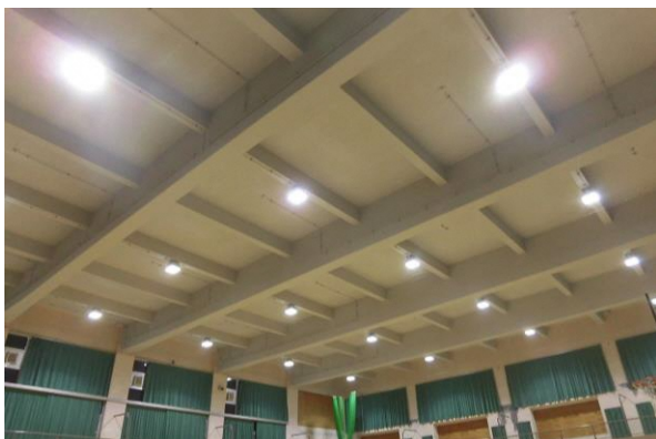
屋内運動場のLED照明
