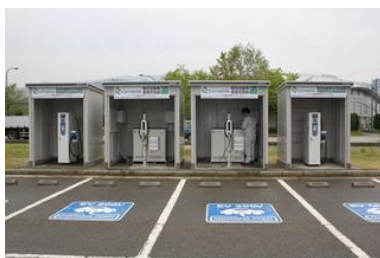
道の駅「関川」 急速充電 2 台、普通充電 2 台
