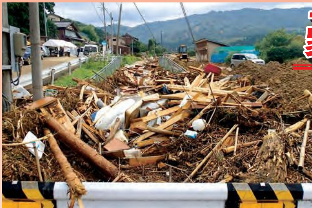
土石流で埋め尽くされた岩鼻幹線用水路（小岩内地内） 出穂期のため早急に復旧作業が行われ、8月19日に通水した
