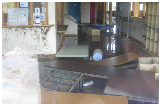
▲保内学童保育所内部の浸水状況
