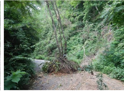
▲浜新保地内 法面崩壊
