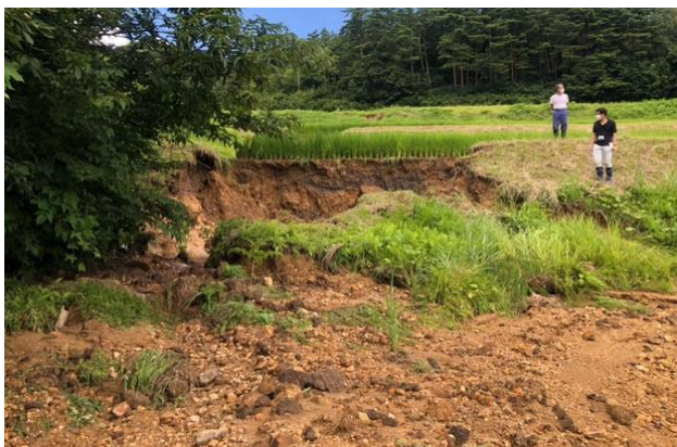
▲蒲萄地内 法面崩壊（棚田の崩壊）
