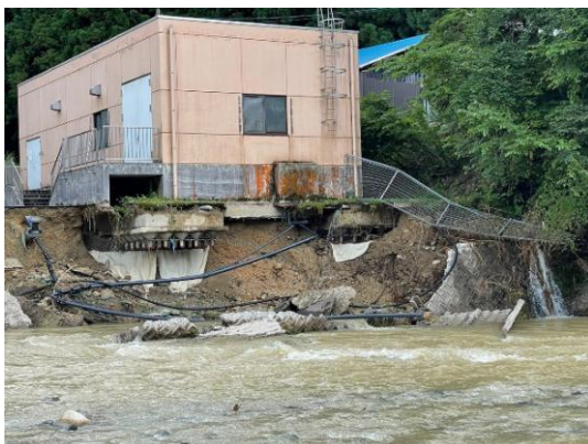
▲高根浄水場被災状況
