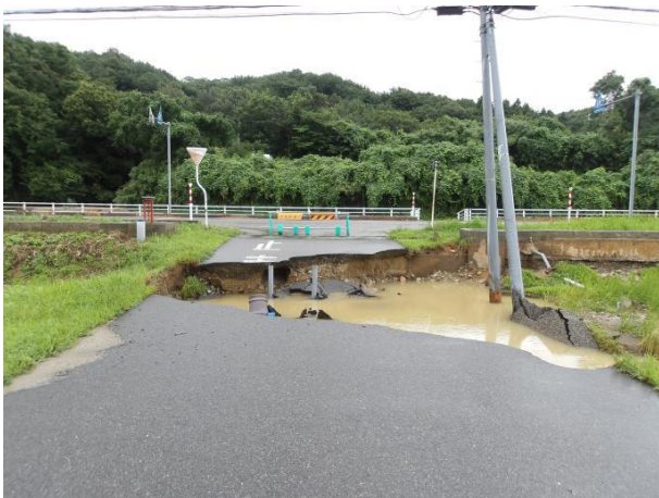
▲荒川地域・市道荒島西線 被災状況
