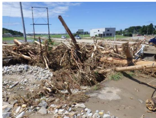
▲荒川大沢川水管橋被災状況
