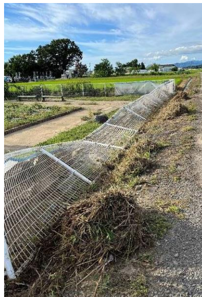
▲水流で倒れたフェンス（保内小学校）
