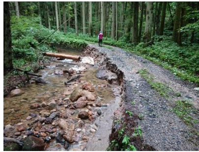
▲黒田地内 河川の増水による林道の崩壊
