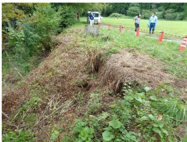
▲法面崩落（旧黒川俣ふれあいセンター）
