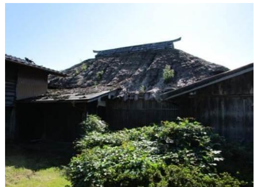
図 荒廃した武家住宅
