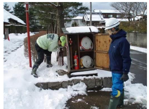
図 文化財に設置された消防設備
