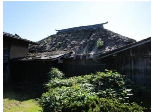
図 荒廃した武家住宅
